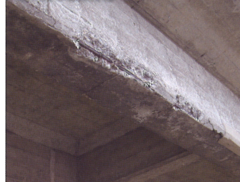
ASR被害状況
